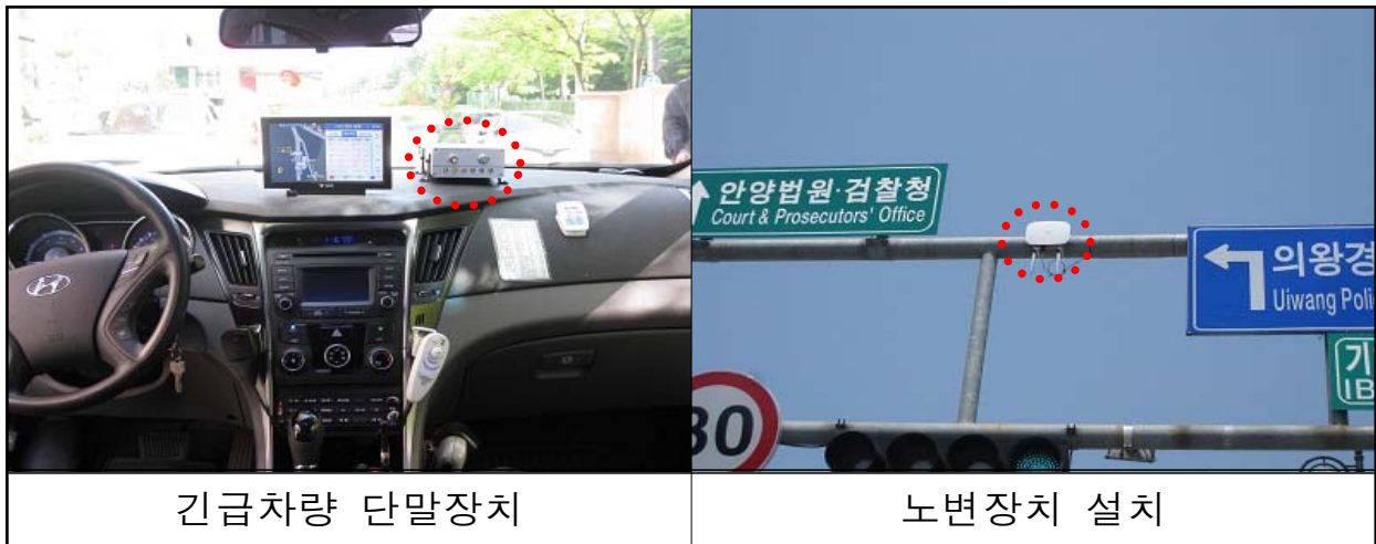
<< 현장장비 설치 사진 >>
