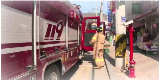
< 지능형소화전 설치사진(경북 예천) >
